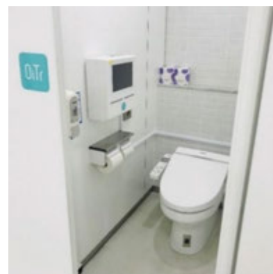
学内トイレに設置しているOiTr
